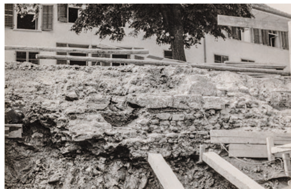
104 Baugrube des Hotels Staadhof 1967 mit mächtigen, sich gegen den Kurplatz fortsetzenden Befunden.
