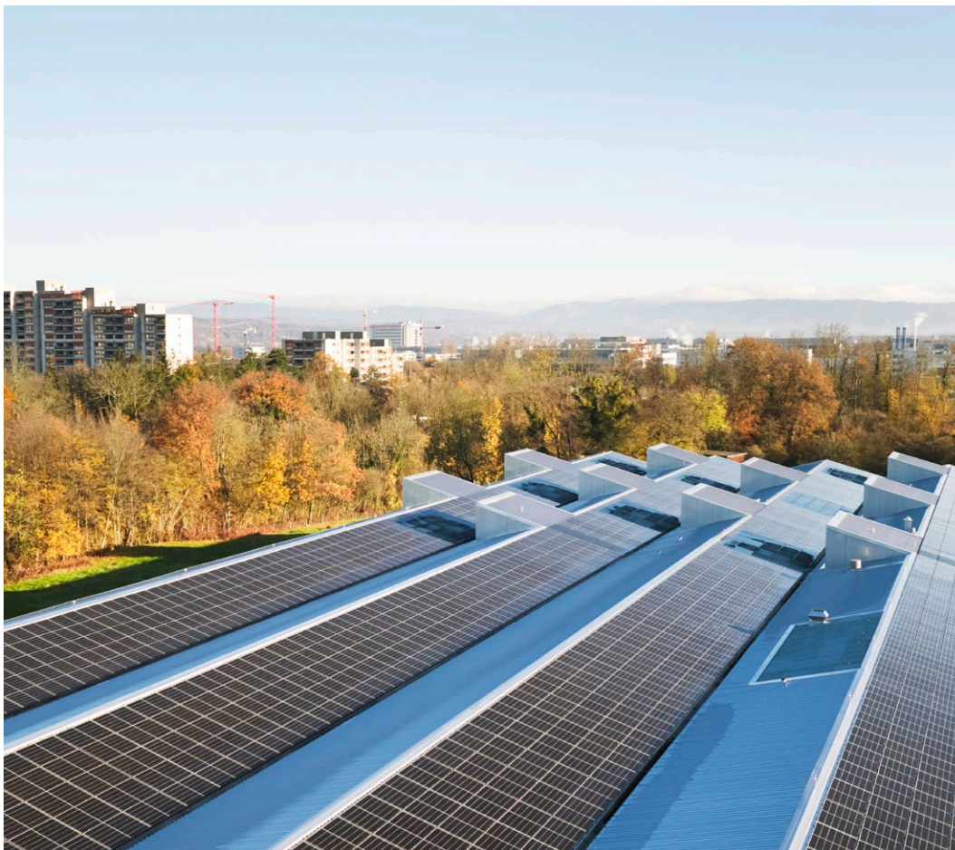
Blick über die Photovoltaik-Anlage Richtung Nordosten. Foto Roman Weyeneth
